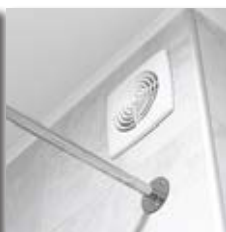
Controlo do exaustor do WC
